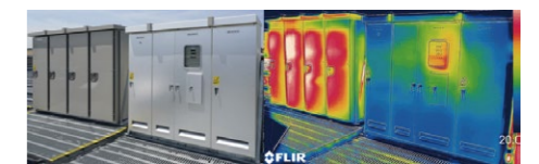
▲ 施工済み分電盤は表面温度が低い
